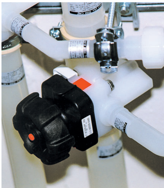
Traitement de l'eau avec des vannes GEMÜ PurePlus
