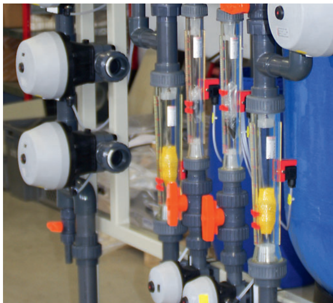
Installation pour le traitement de l'eau
