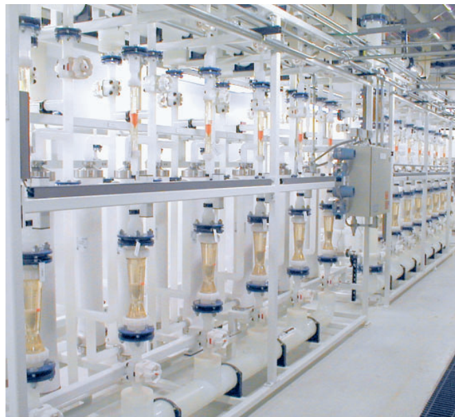
Traitement de l'eau ultra-pure dans l'industrie des semi-conducteurs
